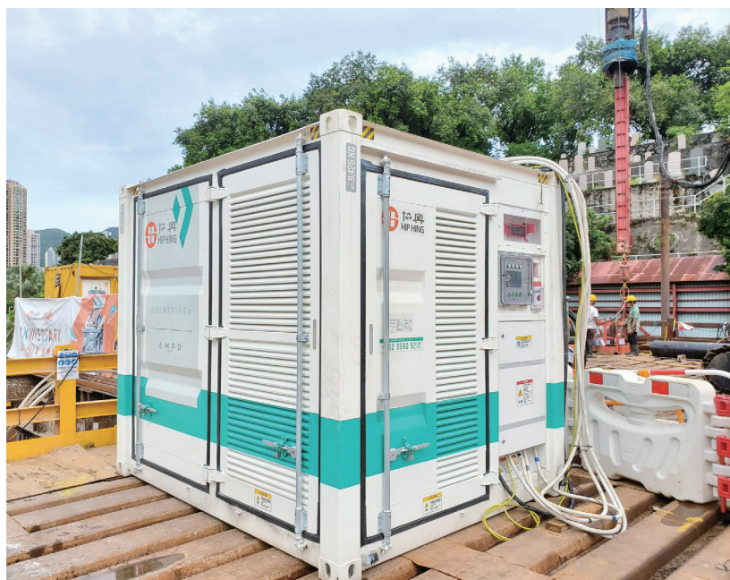
大型電池儲能系統取代傳統柴油發電機
